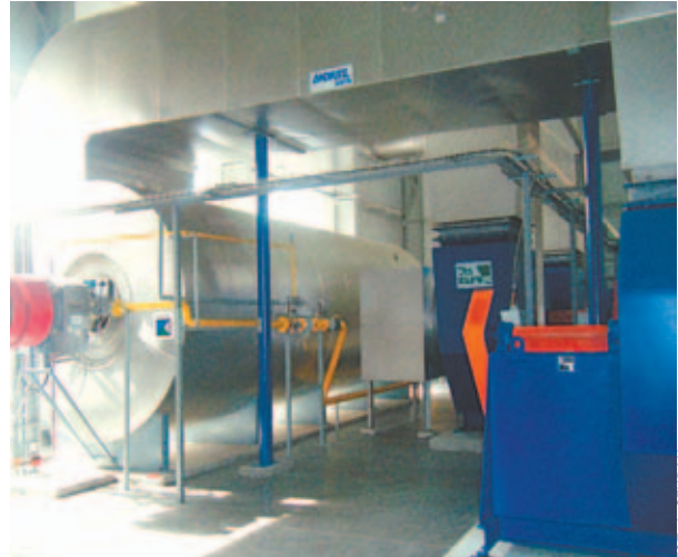
Piec wentylacyjny dostarczający ciepło do suszenia osadów.
