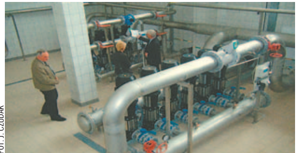
Pomieszczenie pompowni w Nowym Zakładzie Uzdatniania Wody w Woli Batorskiej.
